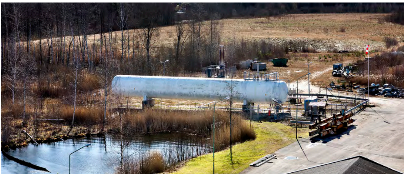
Bolagets gastank avsedd för att jämna ut gasbehovet under processen.
