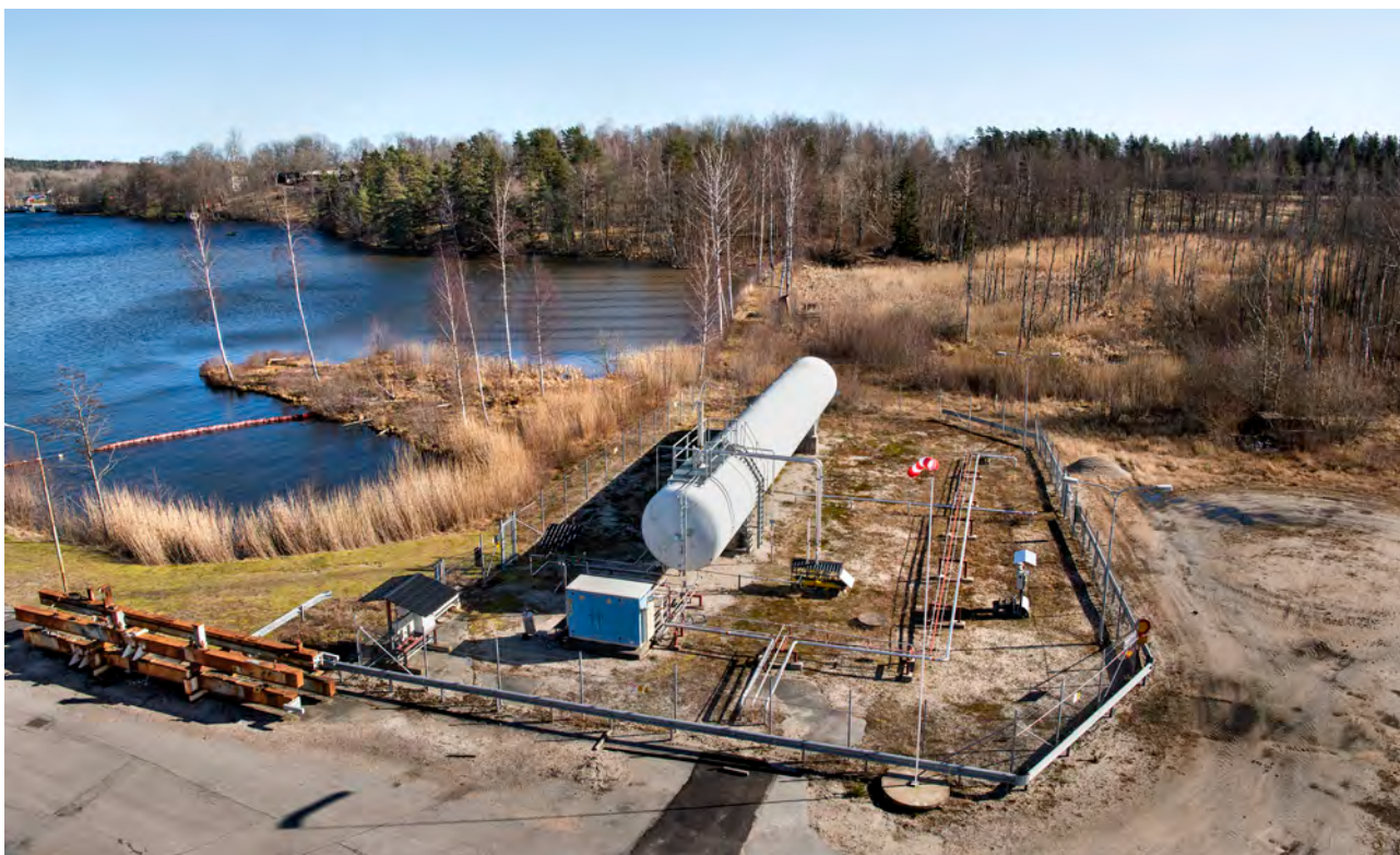
Bolagets gastank avsedd för att jämma ut gasbehovet under processen.
